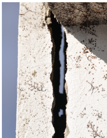
Fissure du béton perpendiculaire à la dalle de la loggia (2011)
