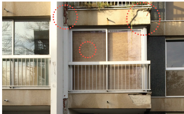
Aciers apparents, décollement de l'enduit et dispositif d'occultation et de correction thermique installé par les habitants (2017)
